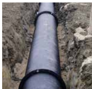
Tuberías de fundición
